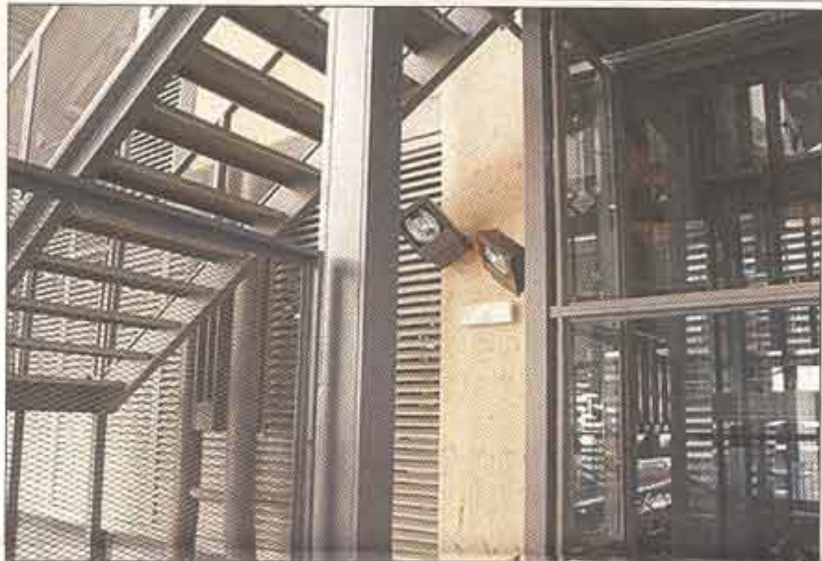
Instalación de los sistemas de alumbrado en el interior del mercado de la Barceloneta.
