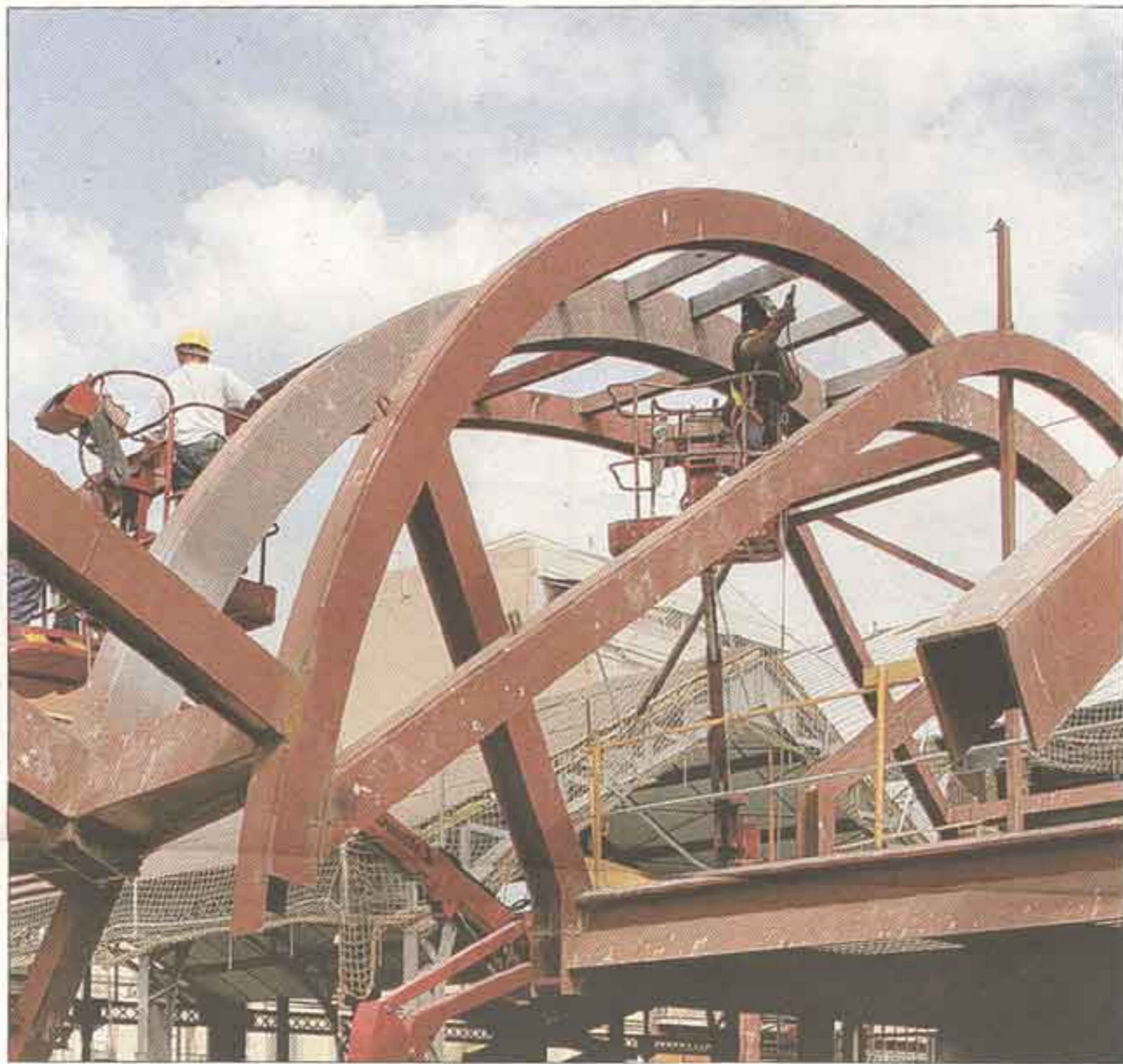
Operarios trabajan en la remodelación de la estructura del mercado de la Barceloneta.
